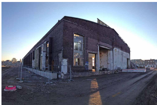
Abb. 5: Fassade des Nordgiebels vor der Sanierung
